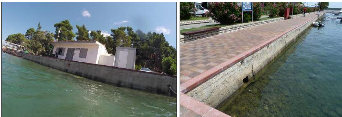
Slika 2.1-8. i slika 2.1-9. Prikaz oštećene, odnosno podlokane obale između pontona
