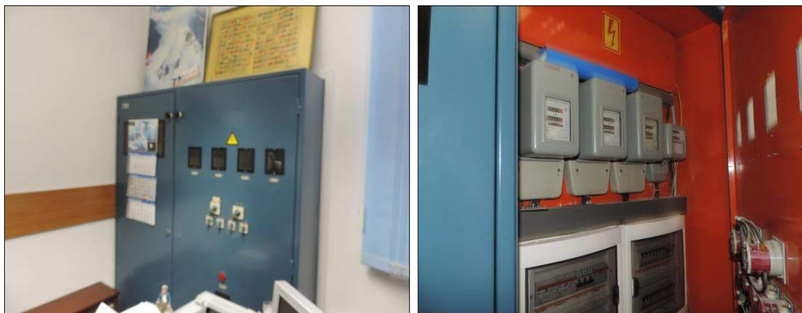
Slika 2.1-14. i slika 2.1-15. Glavni razvodni ormar marine (GRO) sa kontrolnim mjerenjem i opremom
